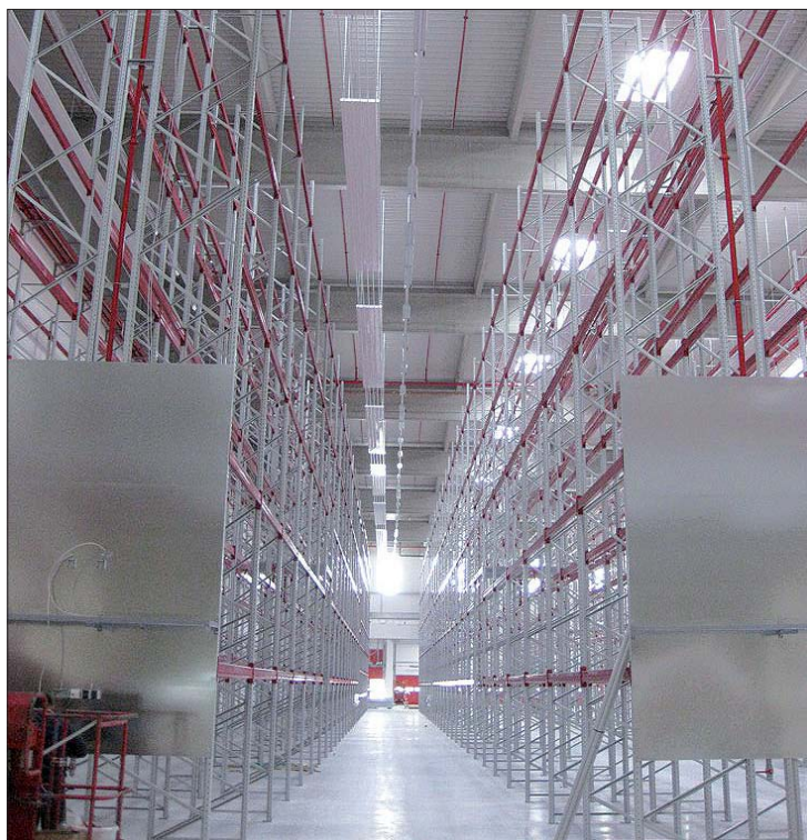
Mittlerweile werden auch im Logistikbereich Betriebskosten konsequent auf die Lebenszeit eines Gebäudes hochgerechnet
